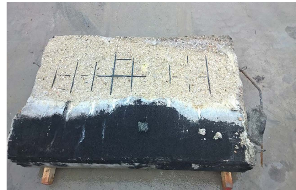
5.3.3.1. ÁBRA Vasbeton falelem tipikus tűzkárosodása.
